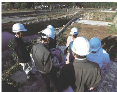
発注者に対する現場での説明。CIMモデルから3Dパースを使うとわかりやすいと好評だ
